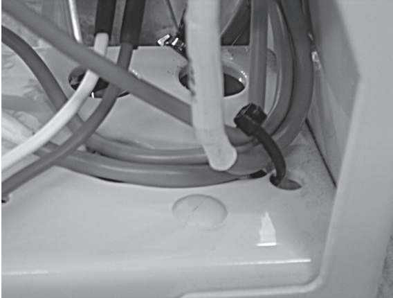
Figure D-9 : Câbles fixés à l'aide d'un lien
