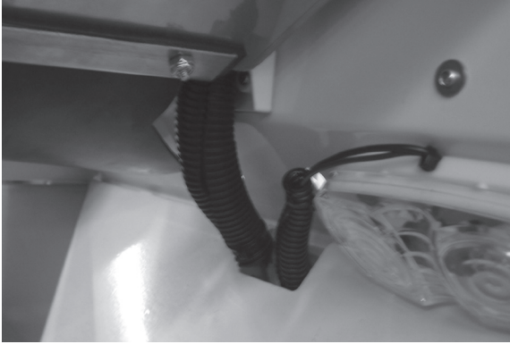
Figure D-7 : Câbles venant du haut de HCGG et reliant la base
